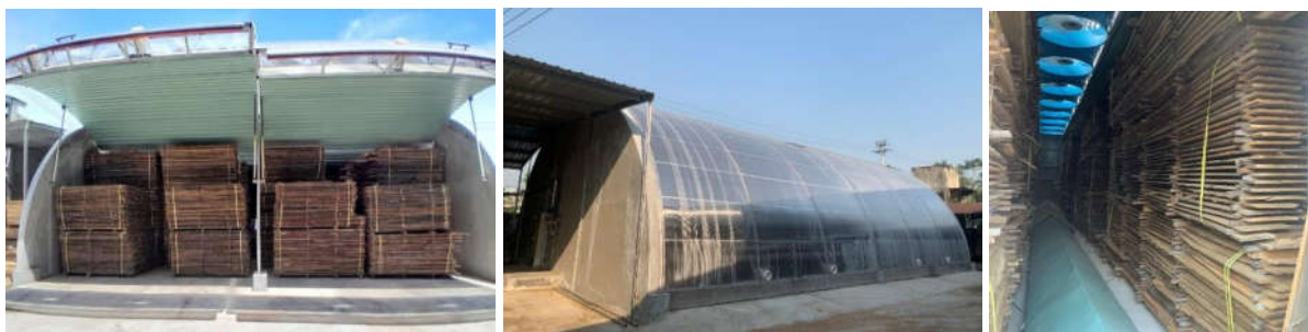
Hình 3. Mô hình hệ thống thiết bị sấy được lắp đặt tại Công ty CP Chế biến gỗ nội thất Thành Tâm
